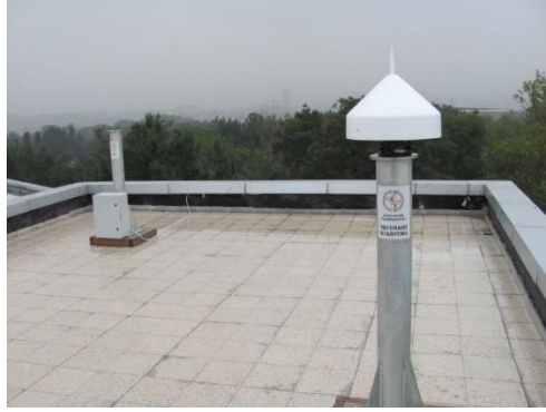
Şekil 2.1 YLDZ GNSS istasyonu
